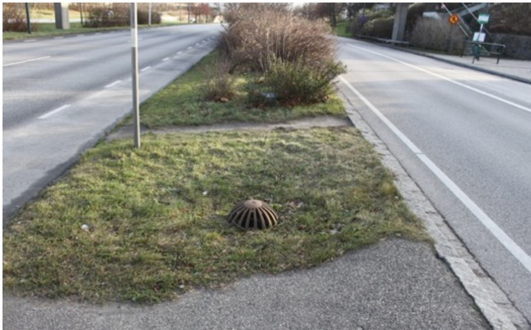
Figur 33, klent dimensionerad dagvattenledning, Malmö (Foto: Kalida Mohammed)
