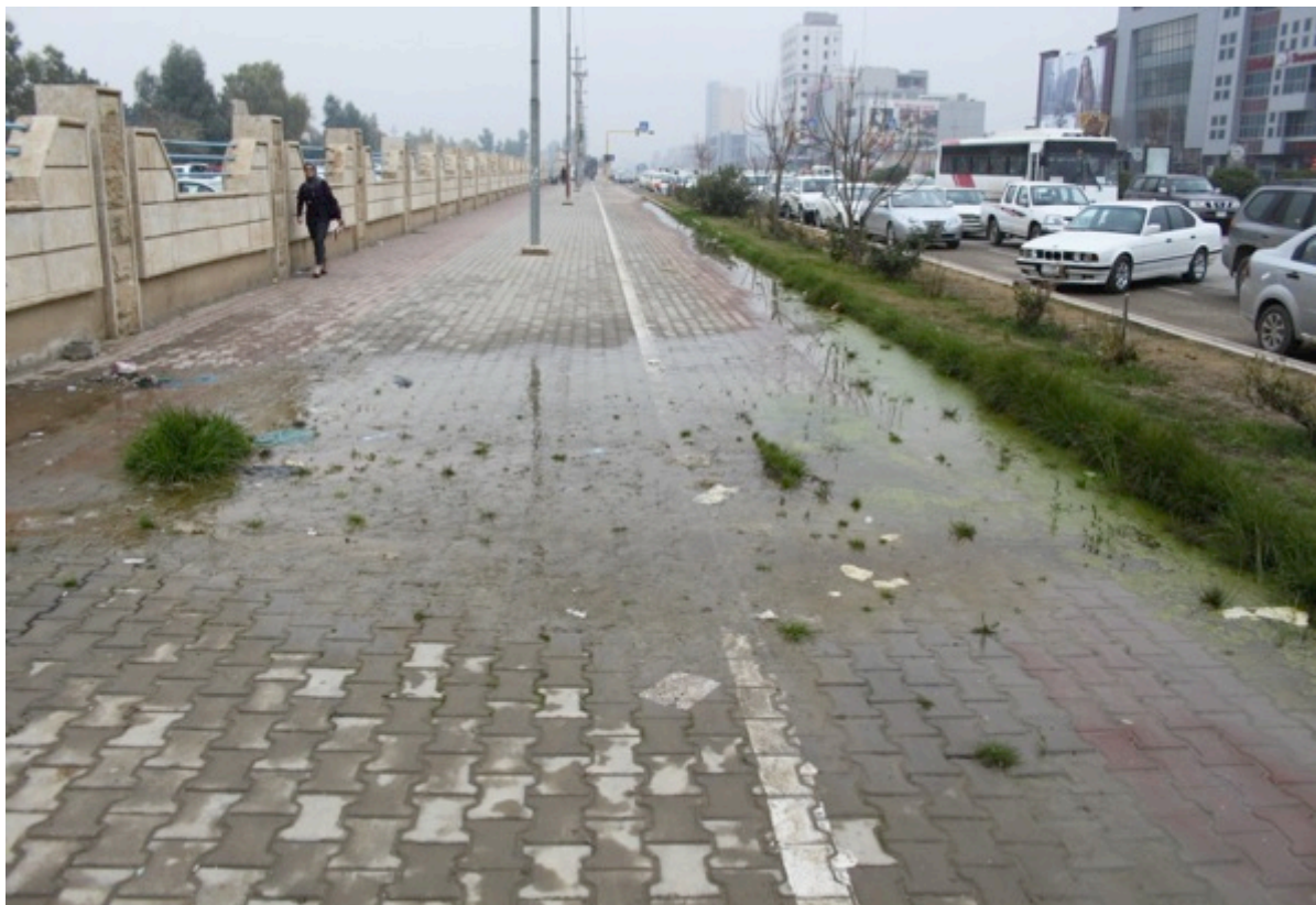
Figur 19, visar läckage från dagvattenledning på gångbanan utmed motorvägen i Hewlêr (Foto: Kalida Mohammed)
