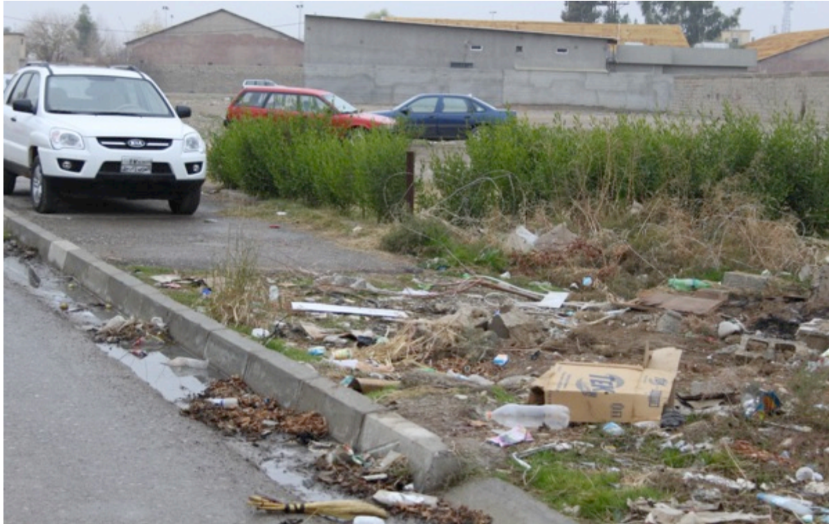
Figur 22, dagvattenkanal i Hewlêr. Löv och skräp orsakar igensättning av kanalen. Flödet som syns på bilden är från en restaurangverksamhet. Här tillåts fett och oljor från verksamheten komma in i dagvattenledningen (Foto: Kalida Mohammed)
