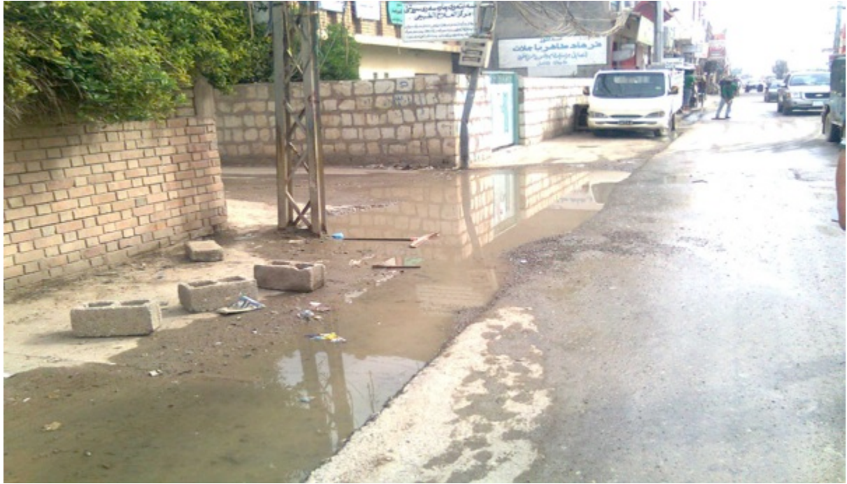
Figur 21, staden Kalar. Fotot är taget efter ett kortvarigt regn under april månad 2011. Det generella syftet med dagvattensystem är att det ska kunna avleda stora som små flöden till ledningarna. Eftersom det saknas dagvattenbrunnar och gatan är av betong kommer det orenade vattnet att stå kvar tills det har avdunstat (Foto ur Kalar kommunarkiv)
