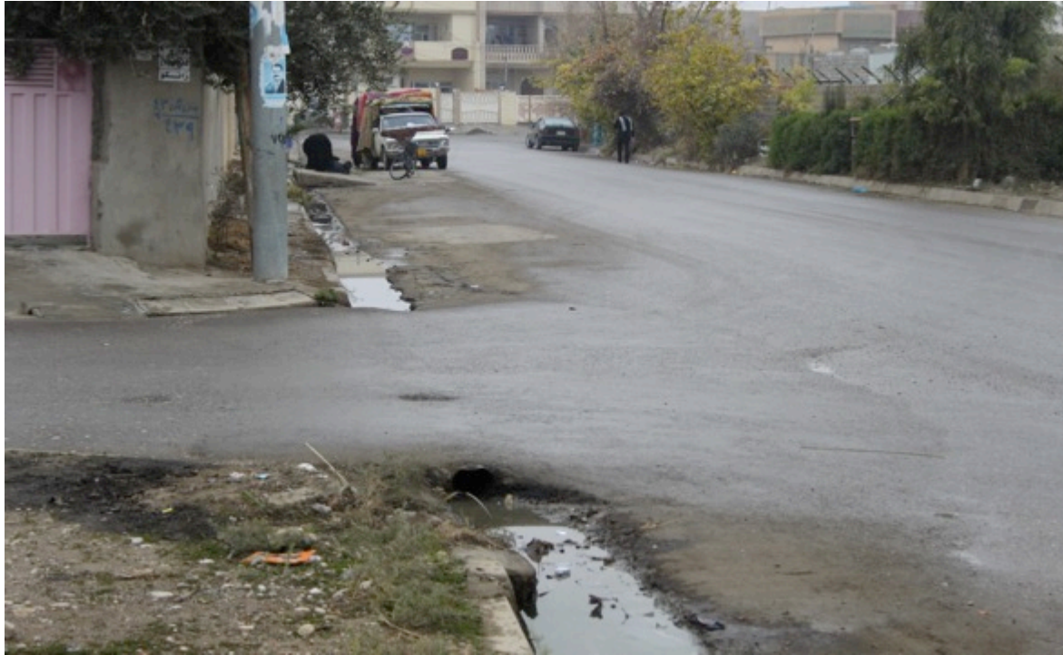
Figur 7, öppet dag- och spillvattendike, bild från Hewlêr visar systemets svaga punkter. Ett oskyddat ledningssystem med risk för igensättning av skräp. Risk för överströmning av förorenat vatten till körbanan (Foto: Kalida Mohammed)
