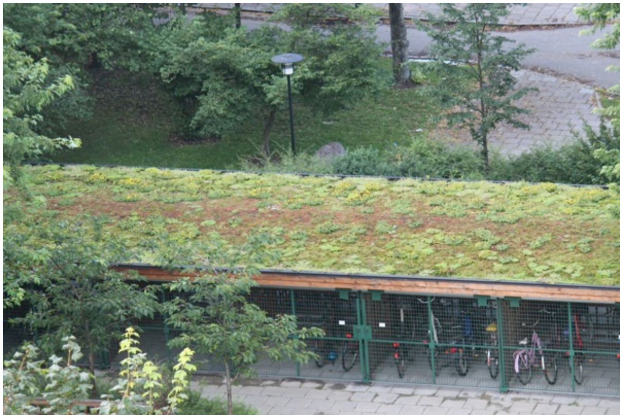
Figur 39, visar en grön takanläggning i bostadsområdet Rosengård, Malmö (Foto: Kalida Mohammed)
