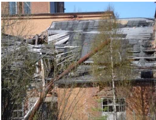
Figur 15. Fabriksbyggnad med rasat tak, (Foto: Elin Larsson 2011-04-29)
