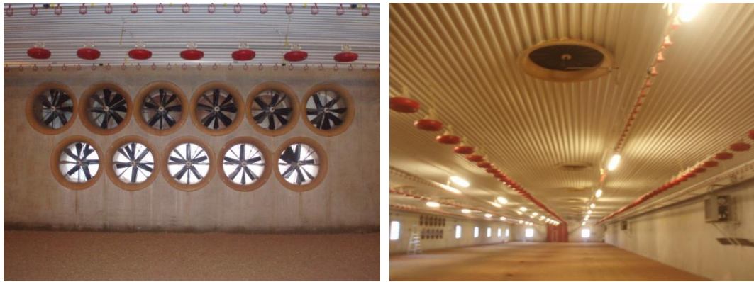
Figur 6: Frånluftsfläktarna och tilluftsdon i stall III.
