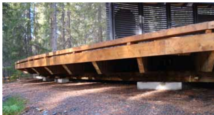
Trädäcket är varsamt placerat i naturen. Den upplyfta lösningen följer riktlinjerna bra.
