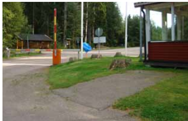
Asfaltsgången som leder rakt in i en vägg.
