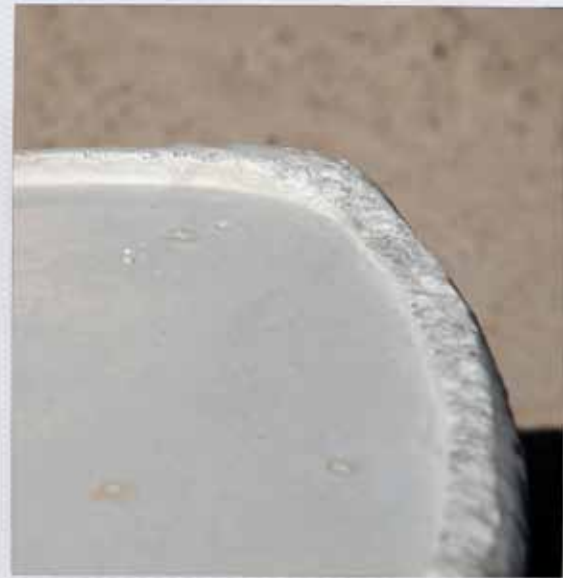
Något skadad betongkant. Troligtvis skedde detta vid avformningen.
