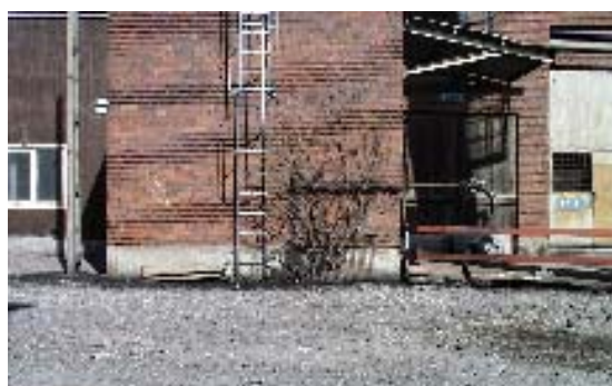
Figur 8. Panncentralen PC 5 (objekt 3). Runt byggnaden finns mörka oljefläckar.
