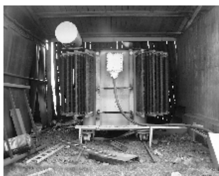
Figur 18. Bild av transformatorn på objekt 8, området är delvis inbyggt (tak och tre väggar).
