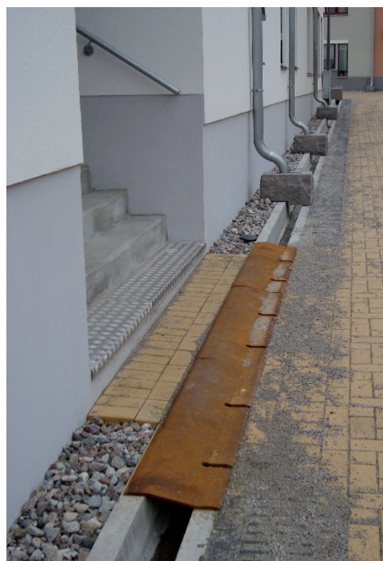
Figur 2. Öppna dagvattenrännor som täcks av stålskivor vid entréer och korsningar.
