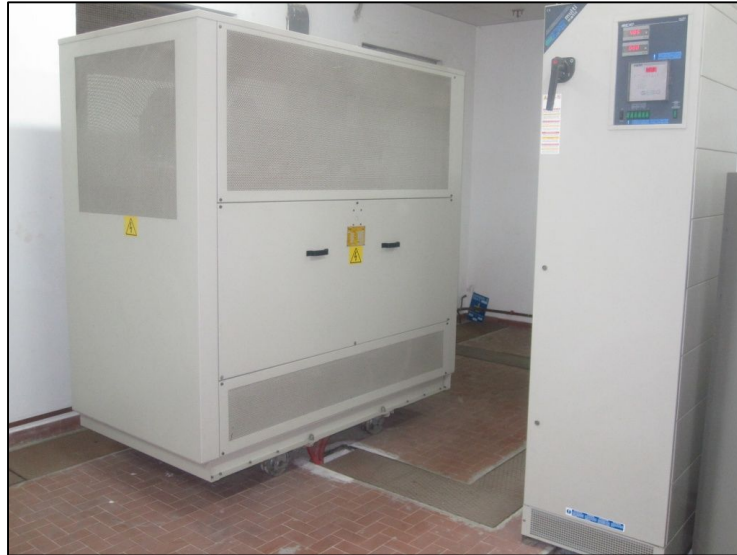
Fig. 39 - Trasformatore e sistema di rifasamento installati presso la cabina elettrica esterna.
