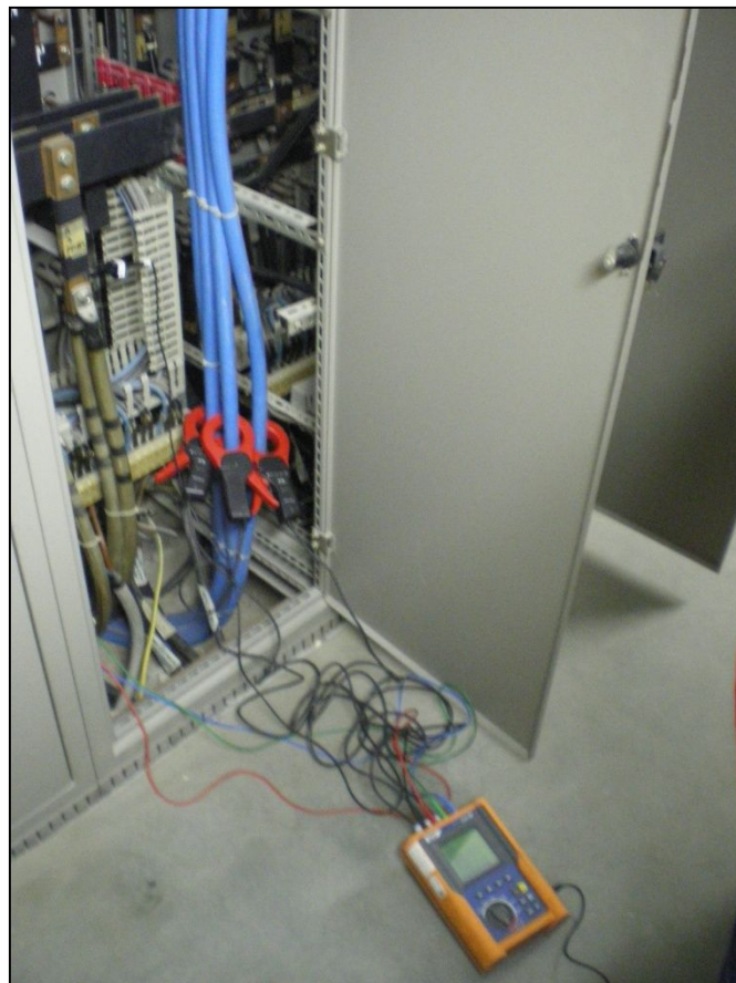
Fig. 40 - Analizzatore di rete collegato ai cavi in arrivo da uno dei tre trasformatori della cabina interrata.
