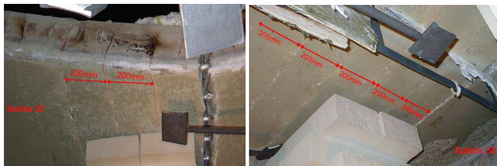
Figura 5.52 Quadro fessurativo rispettivamente sulle solette S5 ed S6
