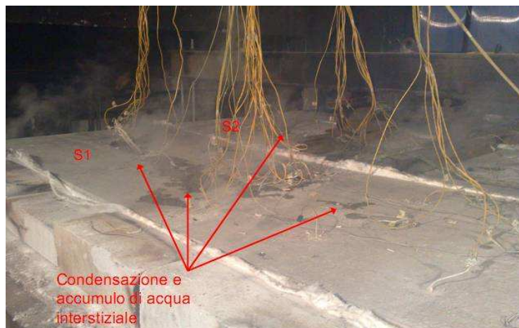
Figura 5.42 Accumulo di acqua all'estradosso delle solette (Prova Set I)
