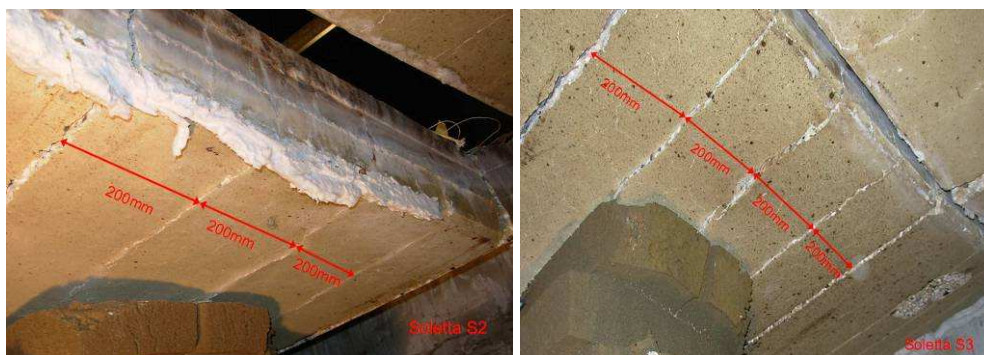
Figura 5.50: Quadro fessurativo rispettivamente sulle solette S2 ed S3
