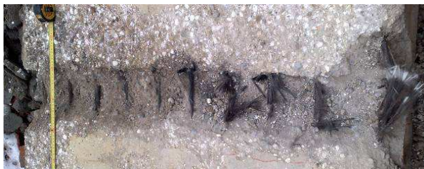
Figura 5.59: Particolare delle barre di armatura nella sezione di rottura
