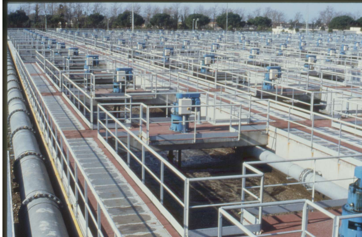
Fig. 9. Vasche di ossidazione biologica dell’Impianto di Depurazione di Cuma.
