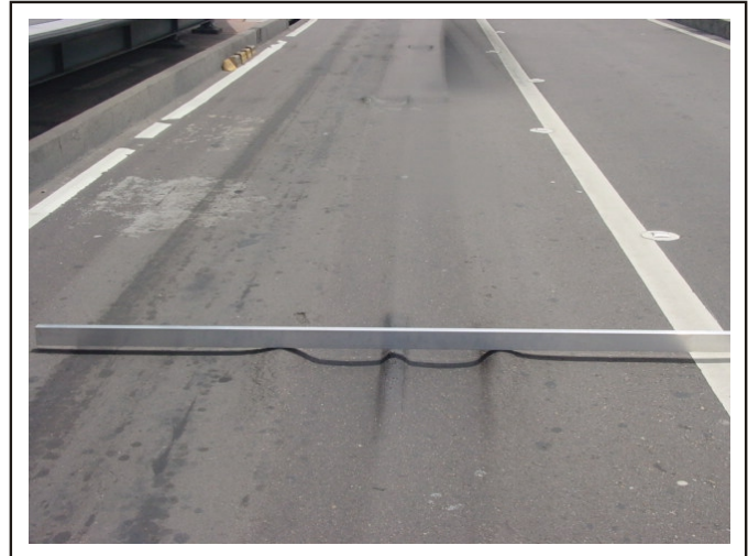
Figura 1. Fenómeno del ahuellamiento. Vía Calle 80 Bogotá Colombia
