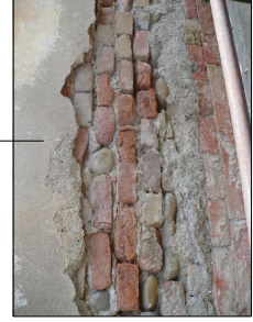
DEGRADO MALTA ED ELEMENTI DI TIPO DIVERSO
