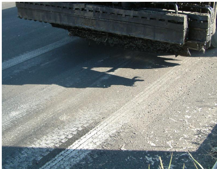
Figura 1.11: Pavimentazione contaminata da detriti e polveri dai mezzi di cantiere.
