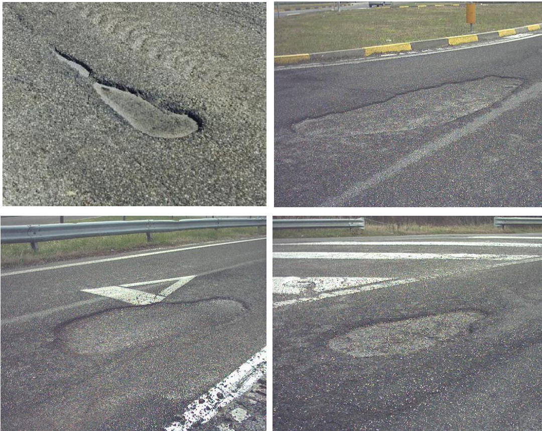
Figura 1.7: Esempi di distacco superficiale di conglomerato bituminoso.
