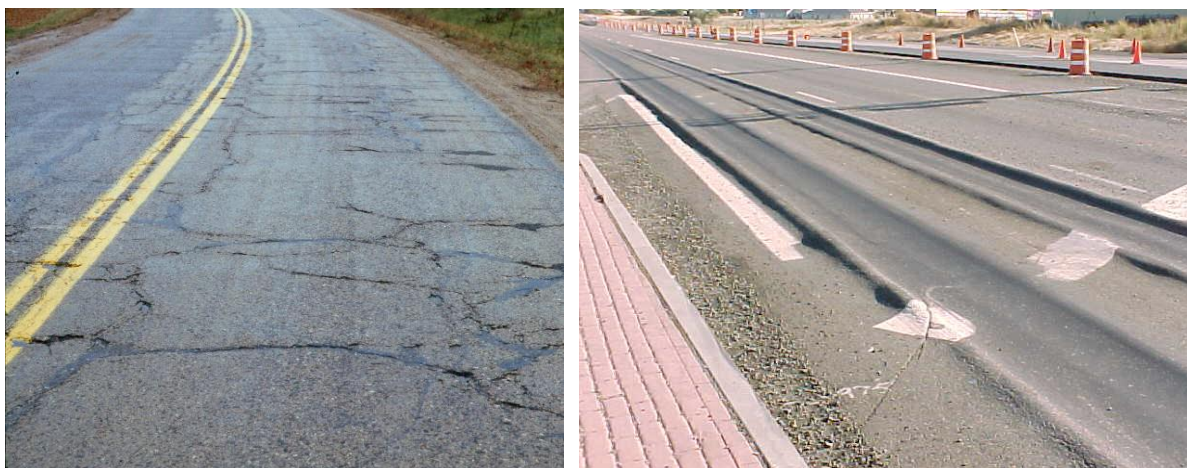
Figura 1.5: Gravi fessurazioni ed ormaiamenti su pavimentazioni stradali.
