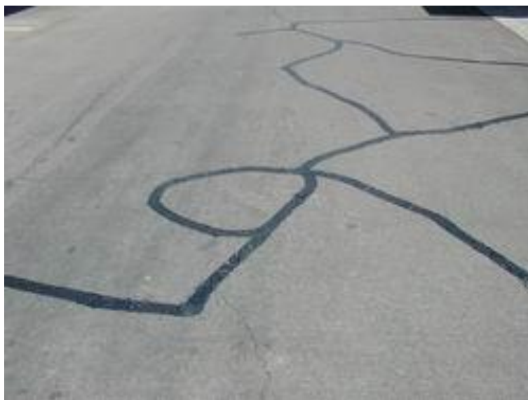
Figura 1.8: Una pavimentazione stradale con fessurazioni sigillate.
