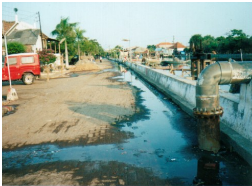
Gambar 4.9 Genangan akibat rembesan dari talud dan pintu air Kali Semarang
