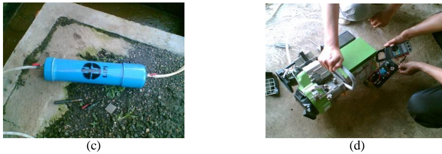
Gambar 1. Modifikasi zeolit lokal Gunungkidul sebagai material penyerap biogas untuk pembangkit listrik: (a) instalasi biogas floating roof , (b) pembuatan pelet zeolit, (c) alat filter biogas, (d) generator listrik biogas
