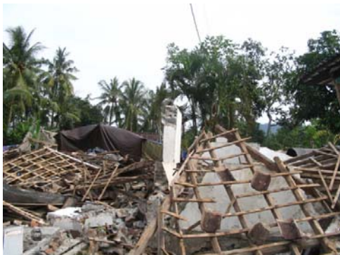
Gbr. Struktur Atap yang roboh beserta dinding pemikulnya ( Sumber. foto pribadi Bp.Sukawi )
