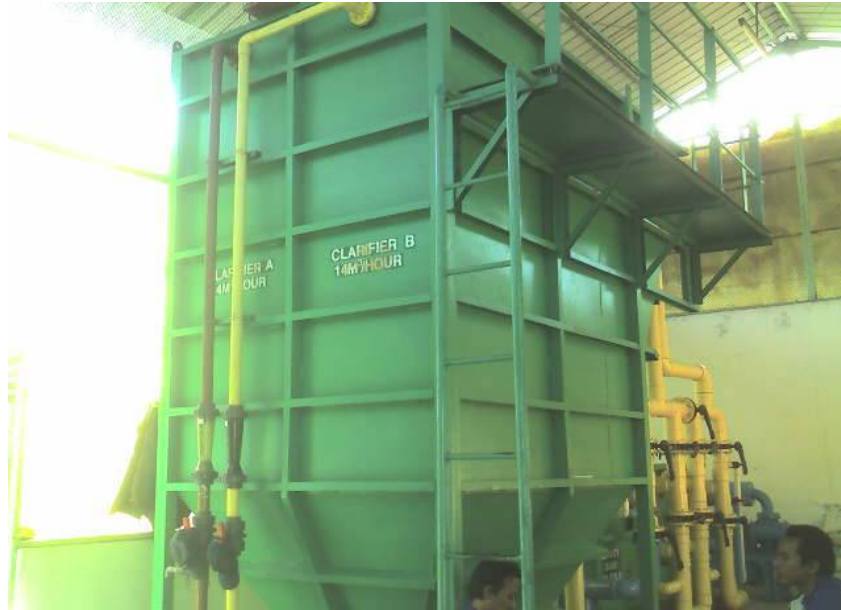
Gambar 1.13. Clarifier pada IPAL PT. Sido Muncul
