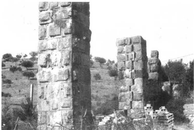
Piliers du pont-aqueduc dans un partie moins élevée et donc dépourvue d'arcs d'entretoisement. Photographie J-P. Laporte, 1992.
