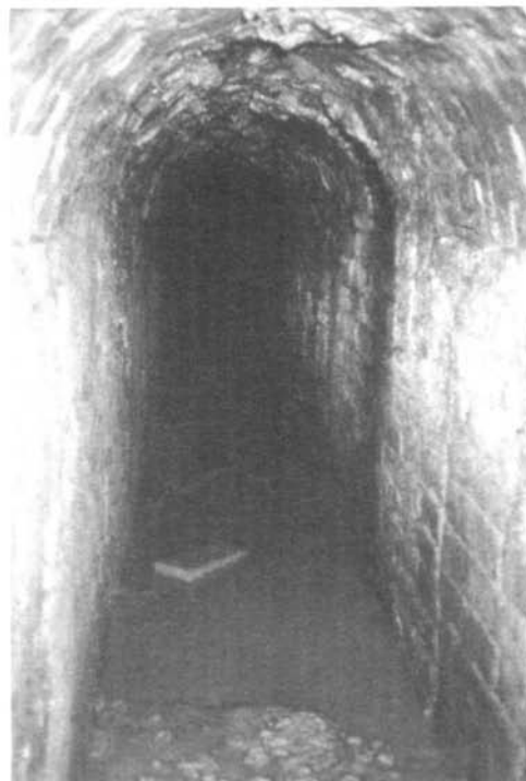
Asolo (Treviso), 'La Bot': stessa situazione in un tratto con foderatura del cavo in laterizio.
