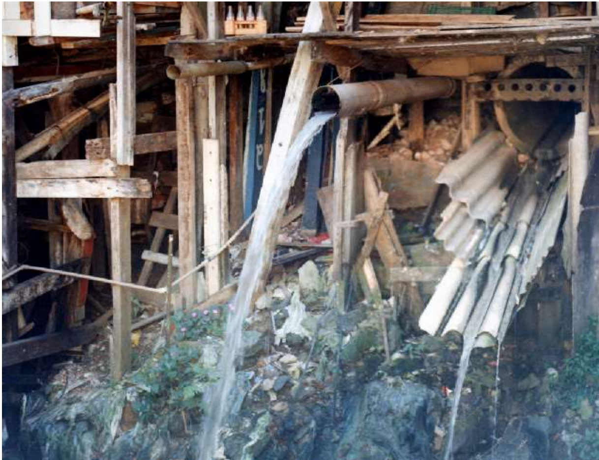
unregulierte Kanalisation (Foto der Verfasserin)
