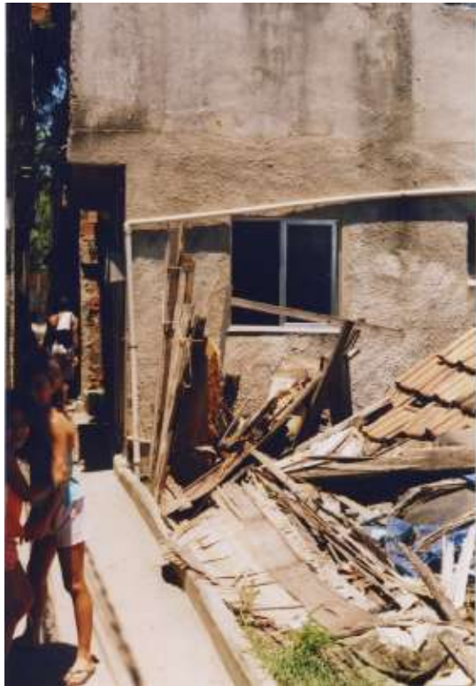
Neue Straßen und zusammenbrechende Häuser, Ladeira dos Funcionários, FavelaBairro (Foto der Verfasserin)
