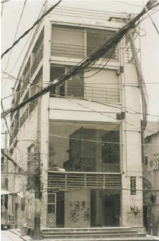
Das von Celula Urbana in Zusammenarbeit mit der Stiftung Bauhaus Dessau errichtete Gemeindezentrum, stark renovierungsbedürftig nach knapp 5 Jahren (Foto der Verfasserin)
