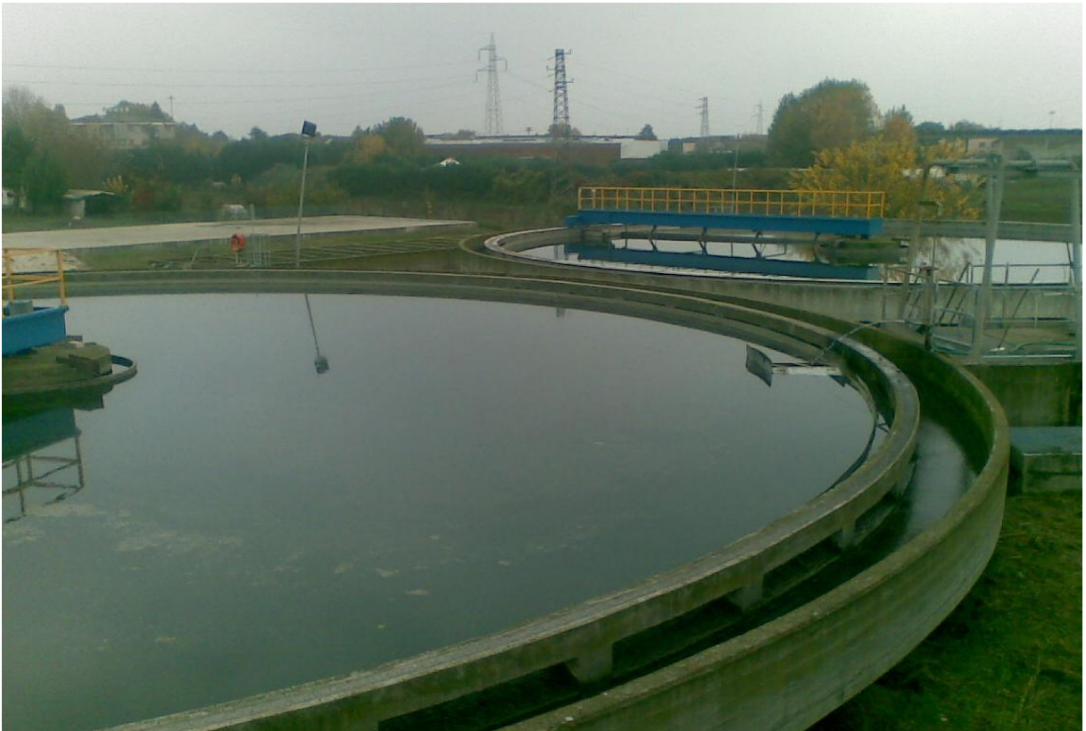
Figura 4-5: Vasche di sedimentazione
