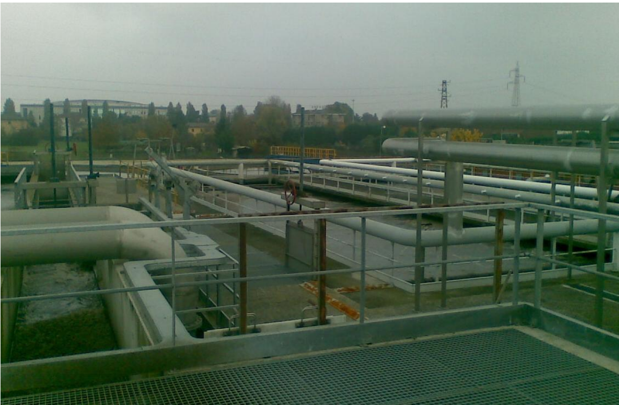
Figura 4-4: Vista del complesso di ossidazione-nitrificazione
