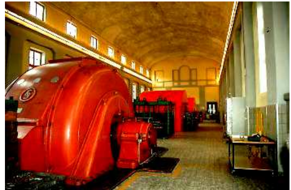
Abb. 7: Generatoren im Kraftwerk Spullersee 96)
