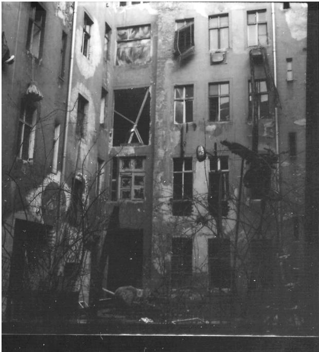
Abbildung 5-1: Verfallener Innenhof, Dunckerstraße 1990
