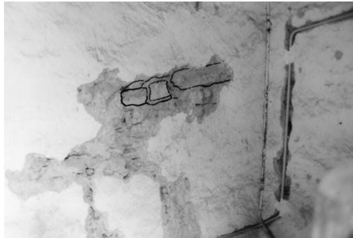
Abb. 9: Stift Altenburg : Anschluss der Westturm-Nordwand an die Langhaus-Giebelwand im ersten Obergeschoß des Zubaus aus dem 18. Jahrhundert.
