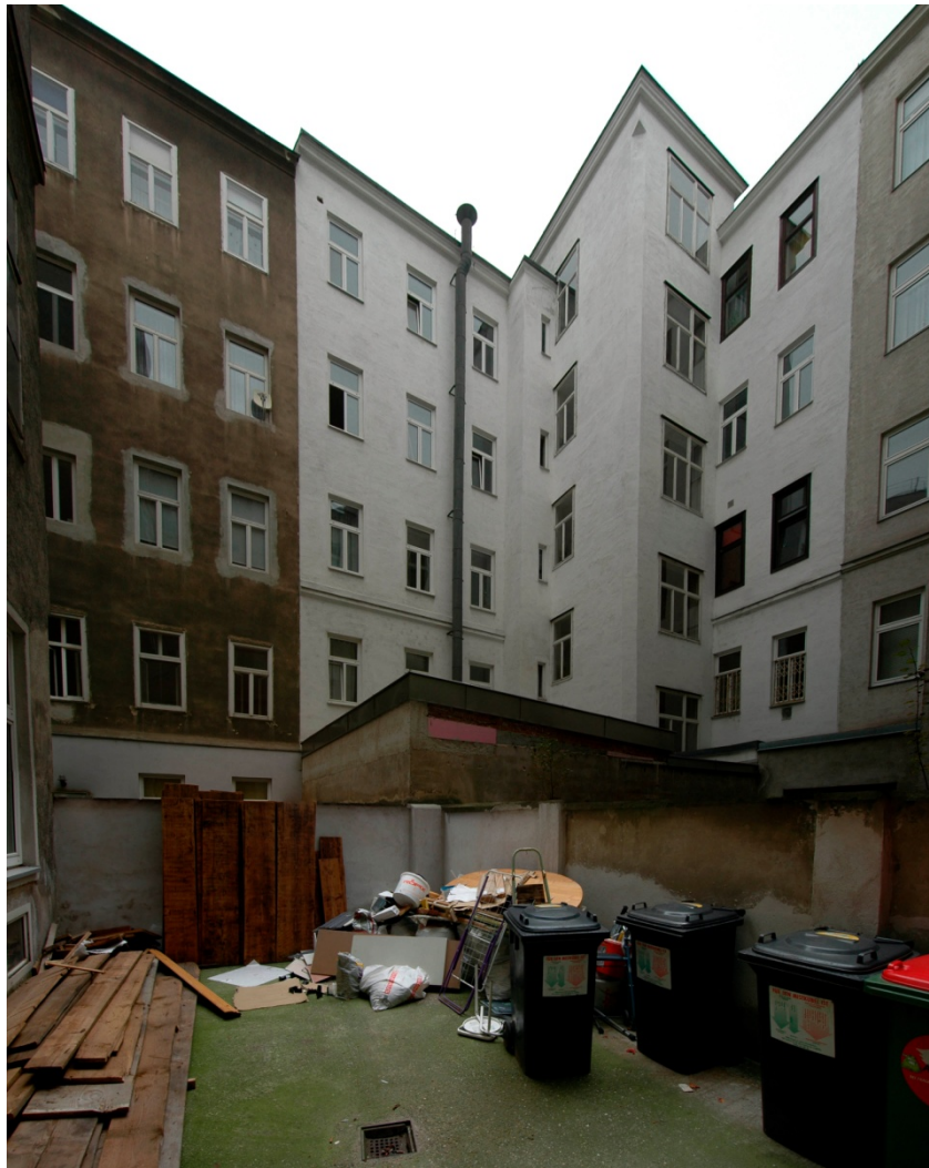
Abbildung 7: Alt- und Neubauten, baufällig. Die Fassaden der Häuser dieses Innenhofes wiesen teilweise starke Beschädigungen auf und wurden daher subjektiv als baufällig eingestuft. Kein Grün. Der Innenhof war komplett asphaltiert. Strohgasse 3, 1030 Wien. Foto: Prof. Alexander Bruckner
