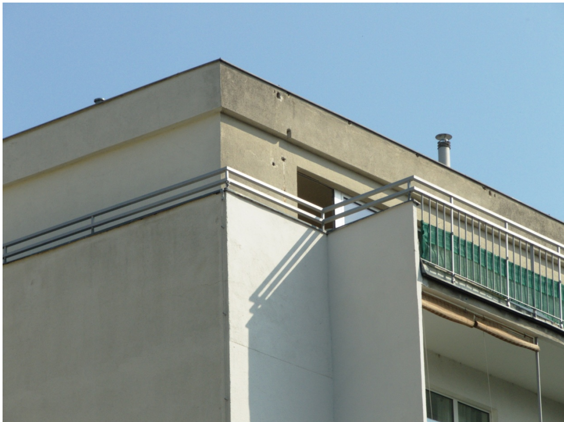
Abbildung 6: Gebäudequartier, leicht beschädigt. Diese Fassade weist Löcher, sowie abgebröckeltes Mauerwerk auf. Jacquingasse 37, 1030 Wien.
