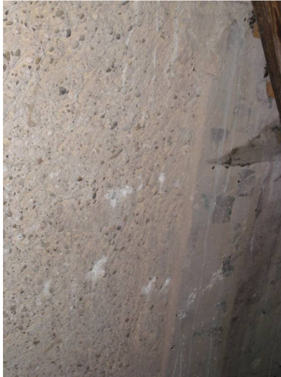
Abb. 159: Hollenburg - Turm Nordaußenwand, Freskoreste
