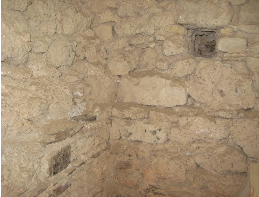
Abb. 155: Hollenburg - Turm, 1.OG, Südwand, Baufuge
