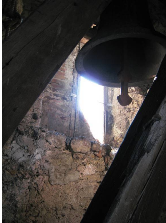
Abb. 157: Hollenburg - Turm, Schallgeschoß, teilweise vermaueretes Fenster
