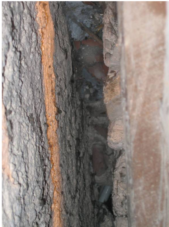
Abb. 162: Hollenburg - Sakristeidachraum, Westwand, Baufuge
