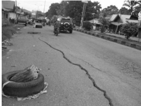
RAJAH 7. Retakan memanjang sepanjang \pm 60 m, \pm 2 m ke arah jalan dengan lebar bukaan sekitar 5 - 10 cm di KM 16.2 Jalan Padang [Pusat Penelitian dan Pengembangan Jalan dan Jembatan (2009)]
