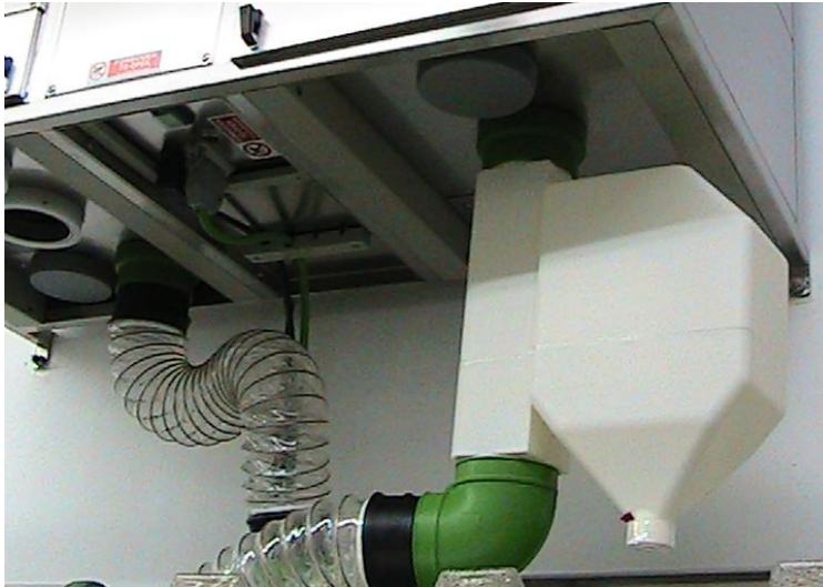
Abbildung 10: Schwerkraftstaubsammler an der IVC Lüfter Einheit
