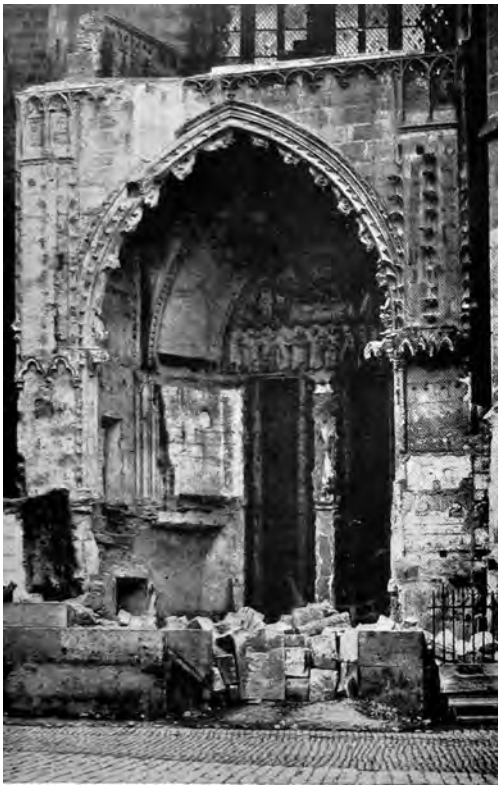
Abb. 159 Metz: Dom, Liebfrauenportal. Gesamtansicht vor der Erneuerung. (Aus: Schmitt 1929, Tafel II.)
