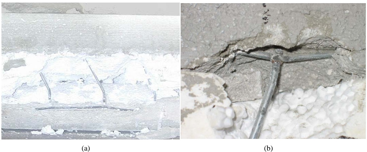
Figura 12.3. Dettaglio del meccanismo rottura osservato (a) nelle pareti 1, 2 e 3 e (b) nelle pareti 4, 5, 6 e 7.
