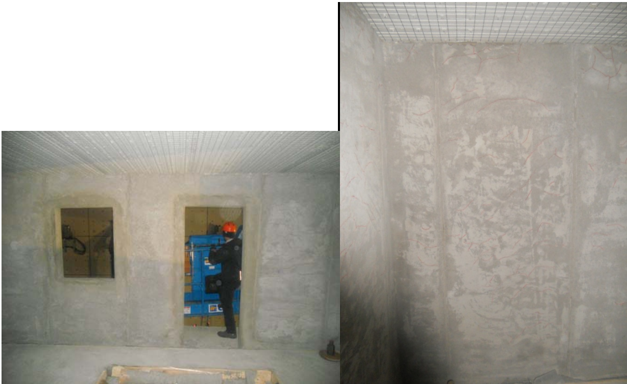
Figura 32.28. Foto delle pareti dopo il white noise a 0.5g: interno piano terzo.
