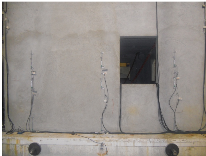
Figura 32.33. Fessure ripassate: foto delle pareti dopo il white noise a 0.5g: esterno piano primo.
