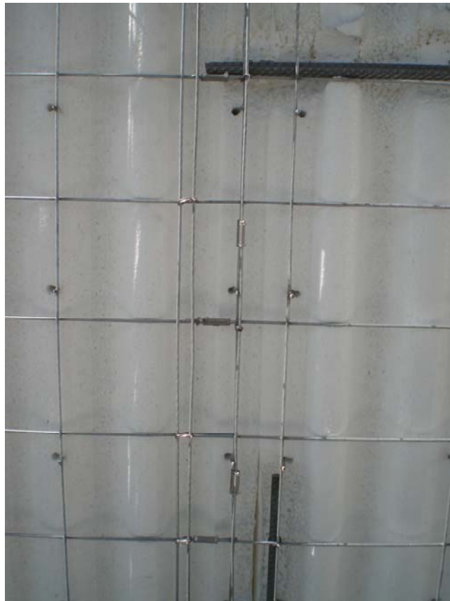
Figura 29.15. Dettaglio del sistema di legatura delle armature orizzontali con clips metalliche a passo 20 cm e fil di ferro a passo 20 cm.
