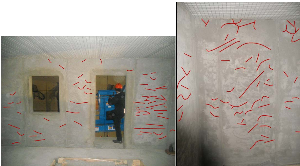
Figura 32.29. Fessure ripassate: foto delle pareti dopo il white noise a 0.5g: interno piano terzo.
