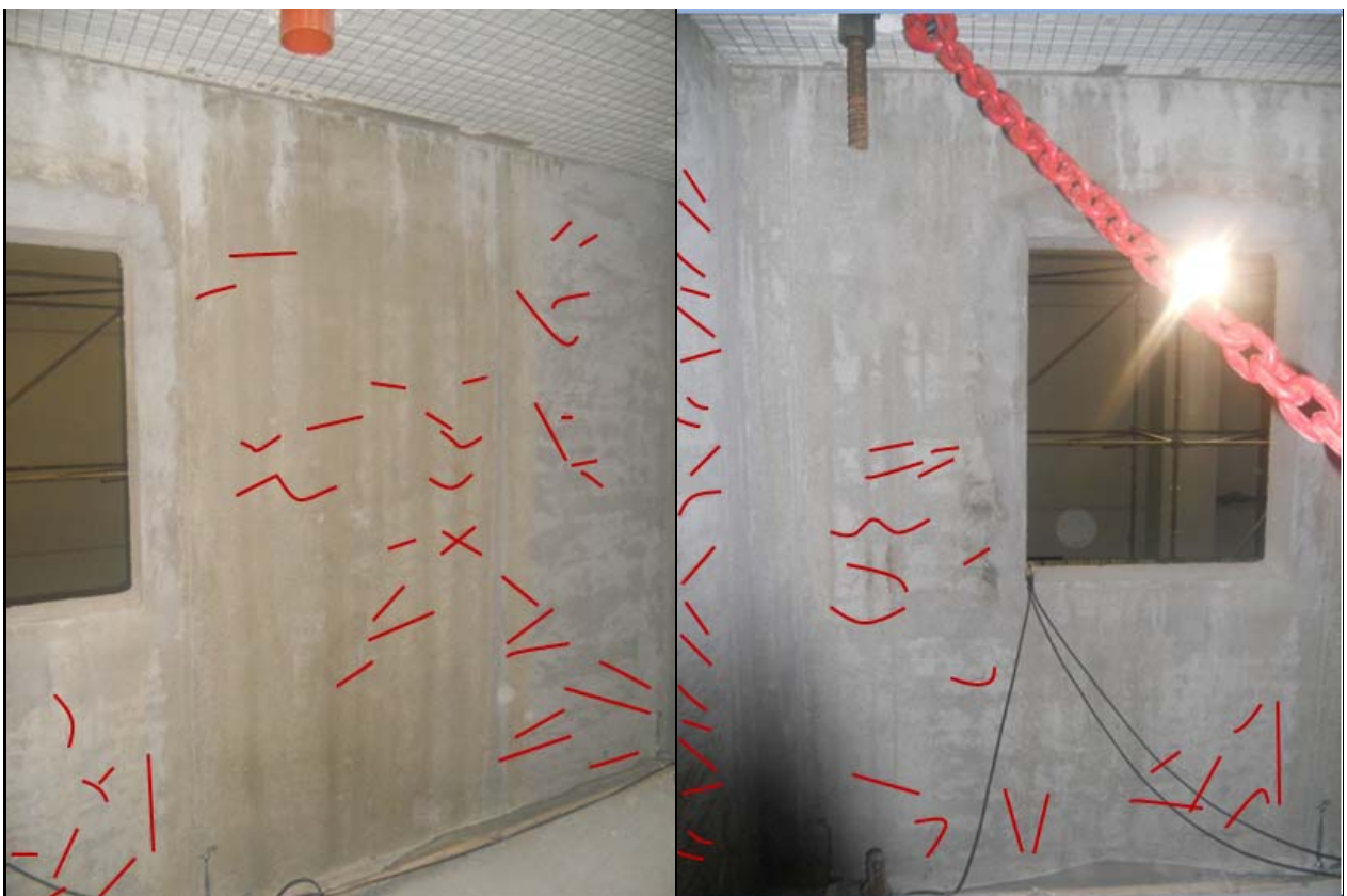
Figura 32.31. Fessure ripassate: foto delle pareti dopo il white noise a 0.5g: interno piano secondo
