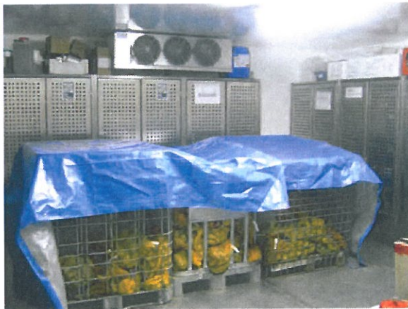
Abbildung 5: Kühlager im ttz Bremerhaven
