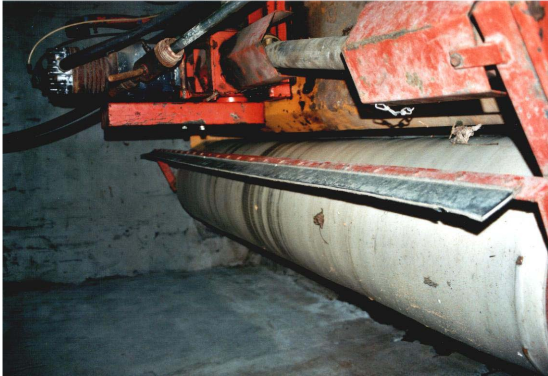
Abbildung 5: Um ein Ausgasen zu vermeiden, wird der Boden mit der Walze gegen die Fahrtrichtung verschmiert
