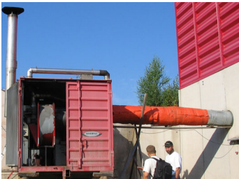
Abbildung 30: Anlage zur Rauchbehandlung in Finnland
