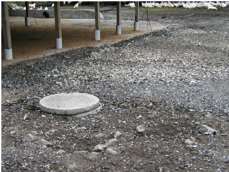
Faskineanlæg til dræning af stærkt vandlidende område i nærarealet. Overdækket - og befæstet nærareal i baggrunden.
