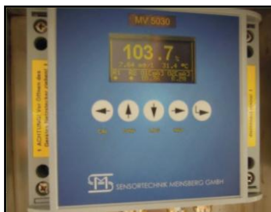
Figura 56: Sensores de de monitoreo y control en los digestores marca MEINSBERG® modelo MV 500. (Fuente: www.meinsberg.de ).
