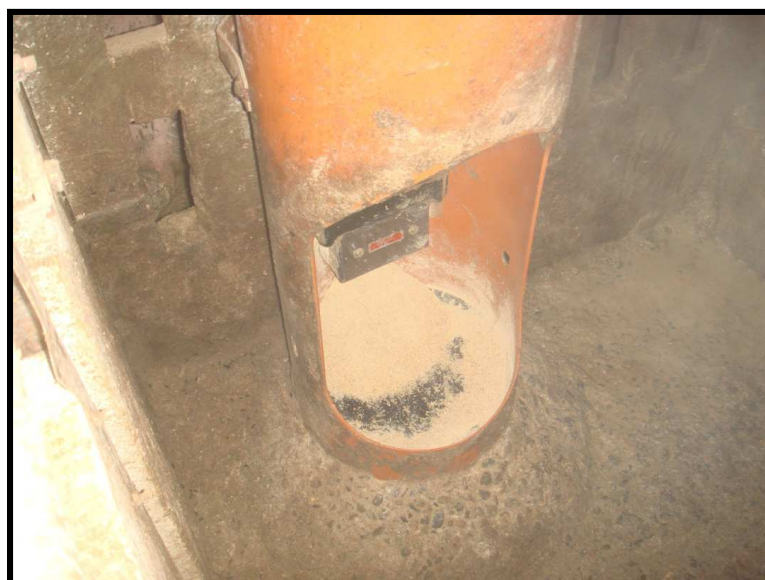
Figura V.19: Tolva de PVC para el suministro de pienso en la granja Ursua Sobejano. (Fuente: elaboración propia).
