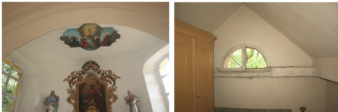
Obr. 9 a 10: Koncha presbytáře a prostor krovu nad předsíní využitý jako schodišťová hala, foto, 2012
