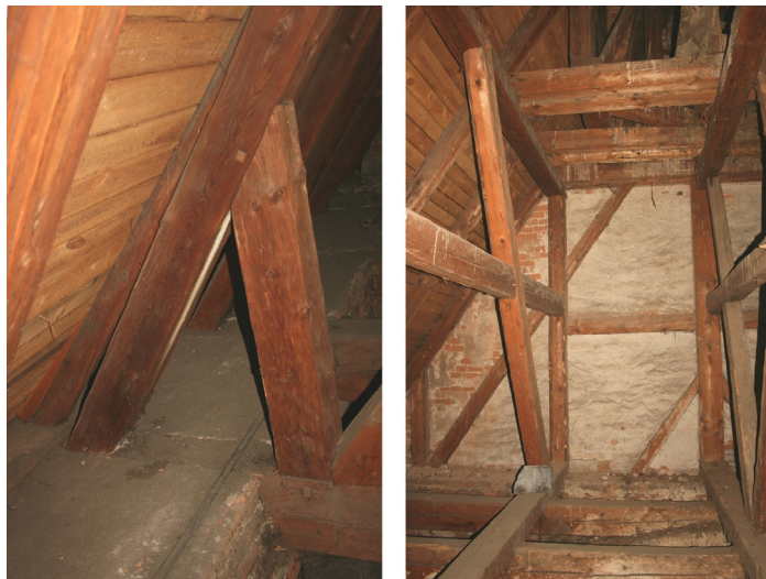
Obr. 17, 18, 19: Patní vzpěra jižní strany krovu lodi a západní štít se zadržovací vazbou, foto, 2012
