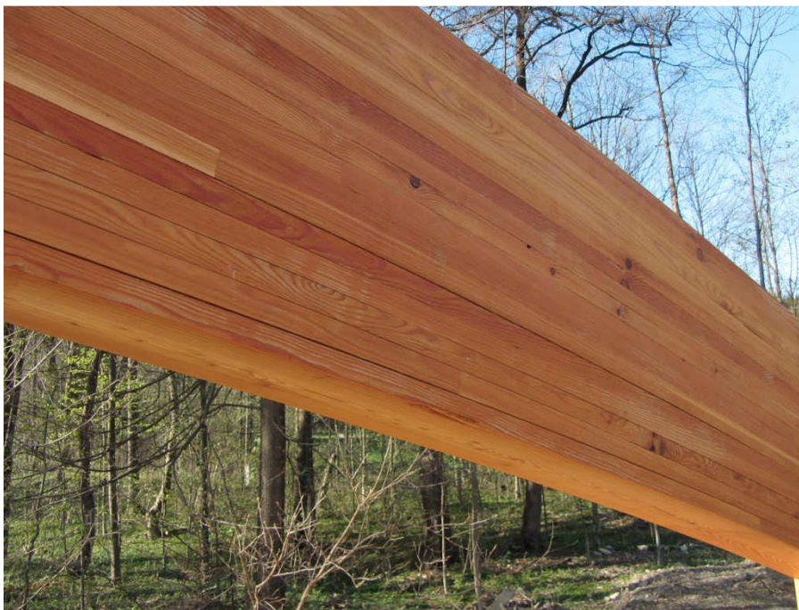
Obr. 2.9-1 – delaminace lepených spojů na nosné konstrukci lávky
