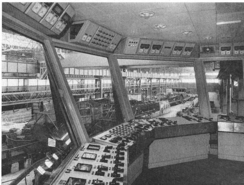
Train à fil de Saulnes. Cabine principale de commande et de contrôle du laminage. (S.A. Hauts fourneaux Saulnes et Gorcy)
