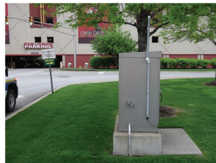
(d) Traffic signal cabinet.
