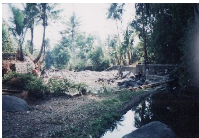
Gambar 2.3 Keadaan Hulu Bendung Susukan sebelum direhabilitasi
